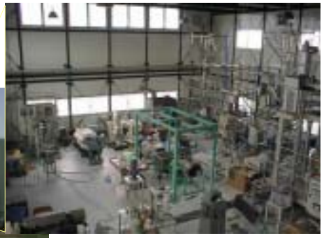
九州工大エコタウン 実証研究施設(内部)
